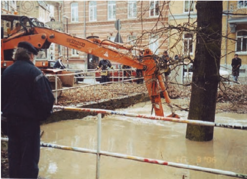
Abbildung 11.3: Räumung am Leutra-Rechen 2006 (Quelle: Stadt Jena)
