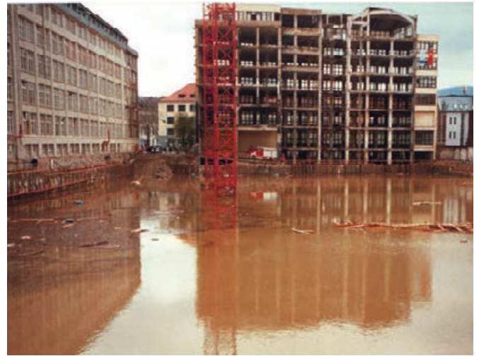
Abbildung 5.5: Überflutete Baugrube der Goethe-Galerie nach einem Hochwasserereignis an der Leutra im April 1994 (Quelle: Stadt Jena)
